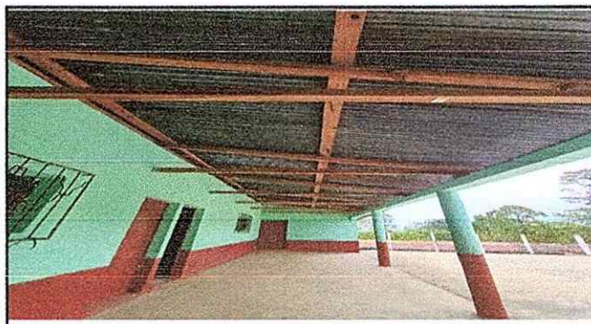
FOTO 4: ESTRUCTURA DE MADERA ANTIGUA Y DETERIORADA
