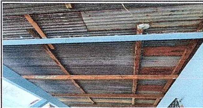
FOTO 1: LÁMINAS Y ESTRUCTURA DETERIORADAS
